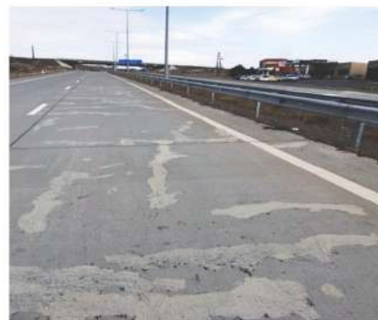
Рисунок 3. Примеры повреждений цементобетонных покрытий на дорогах СНГ
