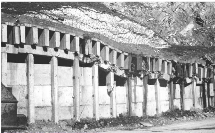
Рис. 1. Частично разрушенная лавиной противолавинная галерея. 1987 г. (фото Р. Тавасиева) [1]
