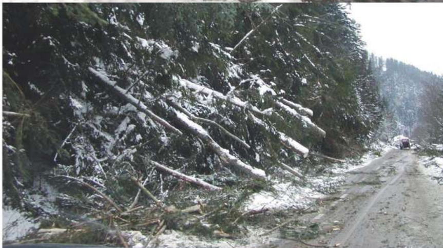
Ликвидация последствий лавины на дороге в горном районе
