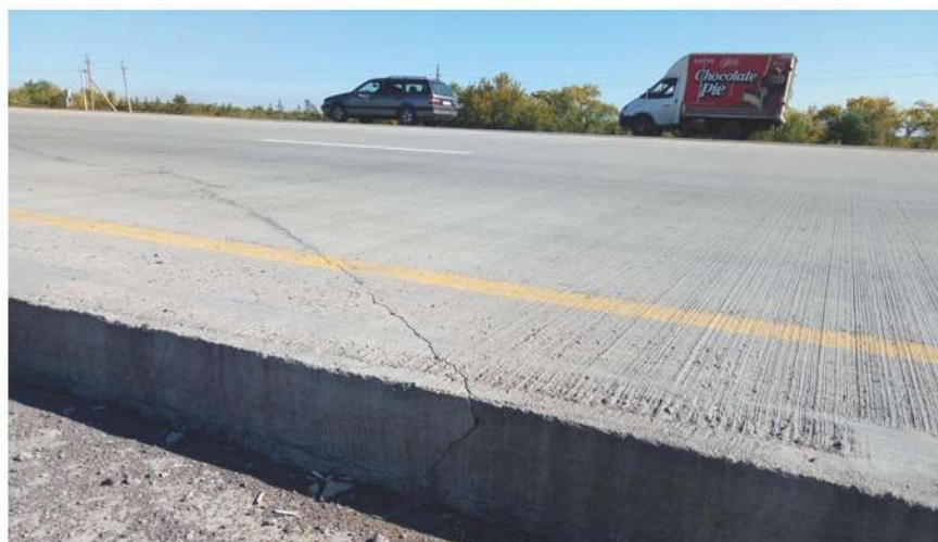
Рисунок 4. Фото трещины на цементобетонном покрытии автомобильной дороги «Караганда – Темиртау» ( abctv. kz)
